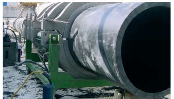
Abwasserpumpleitungen innerhalb von Anlagen. Verschweisst bis \varnothing 1200 mm in Abwasserreinigungsanlage
